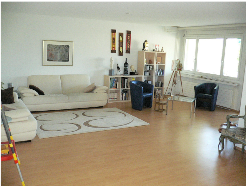
Weisser Abrieb an Wänden und Decken. Kunststofffenster, gut isolierte Fassaden
